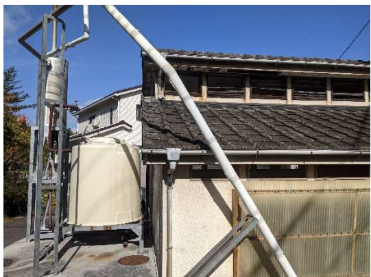
噴気と水で熱交換しカップータンクに貯めて 給湯を行っている
