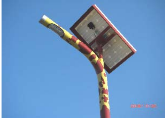
写真5 ソラキリン（照明側） 高輝度白色LED10Wで日没から翌日日の出まで照明時間調節可能。 無日照補償5日。ランプ設置位置は地面より約3.7m
