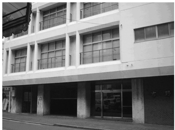
写真2. 熱海の旅館。一階が駐車場のピロティ柱は大地震で倒壊する危険性が高い。
