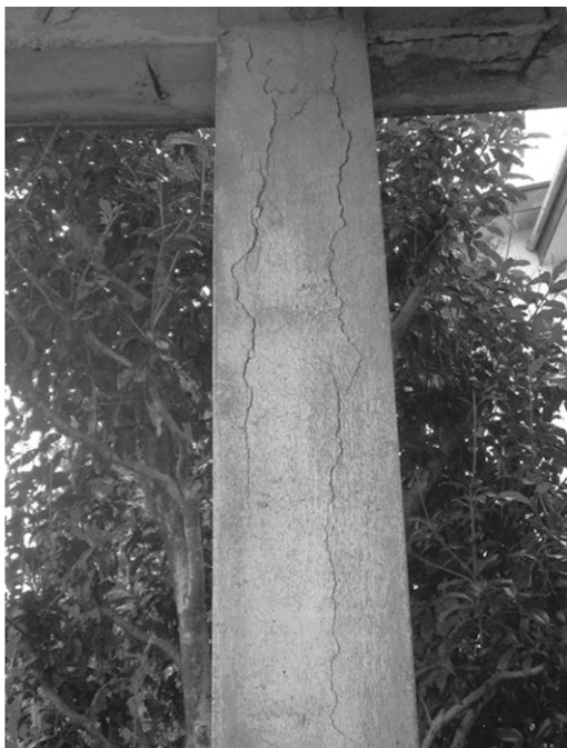
写真1. 熱海にあるコンクリートの柱。亀裂が入り大地震時には折れてしまう危険が高い。
