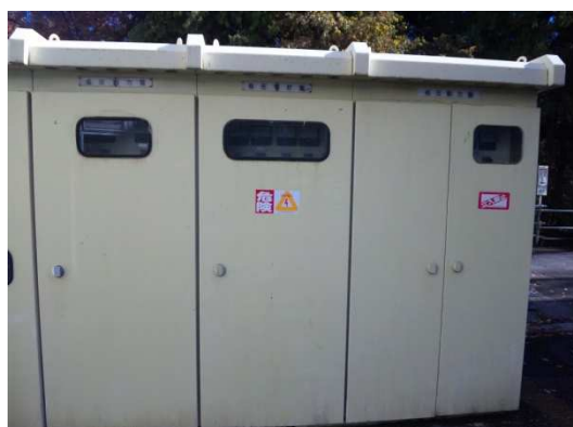
図 12 キュービクルの設置例
