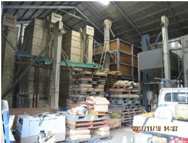
遠赤外線乾燥機、放冷タンク、粃摺り機、色彩選別機等の機械類（その１）
